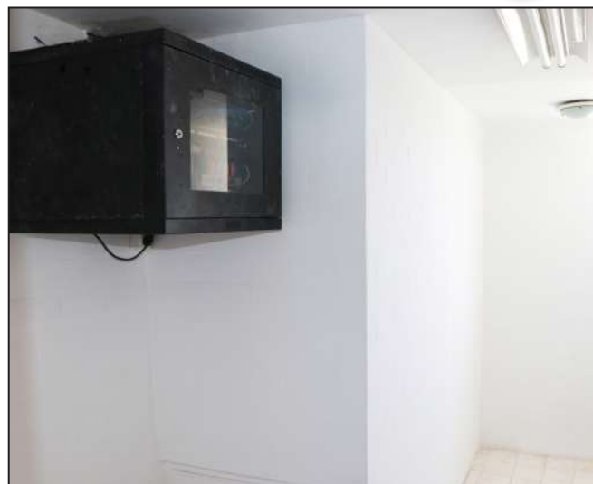
تجهیز اتاق رک
