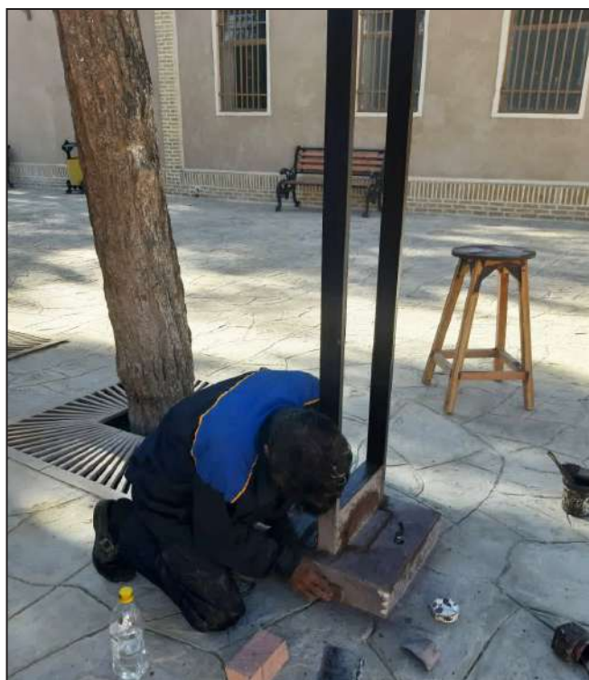
اصلاح پایه تابلو رهنما
